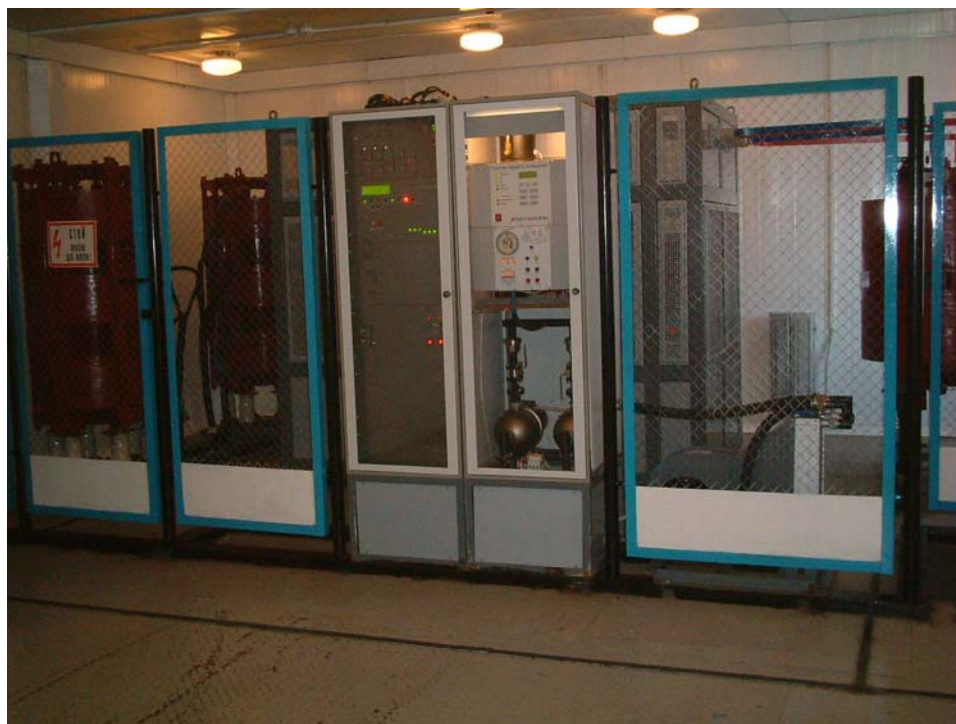
Рис.2. Общий вид установки ТПЧ
